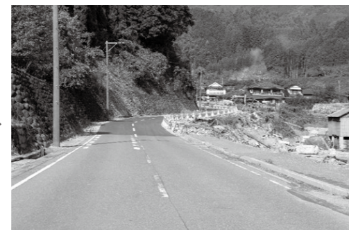
激流で舗装が崩壊した県道52号線と復旧後の現在の状況
