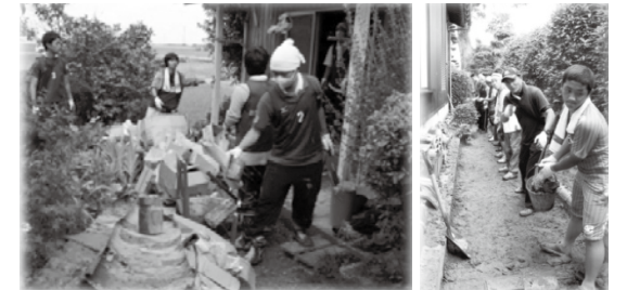
ボランティアにより被災家屋から土砂や廃棄物を搬出
